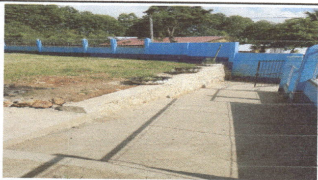
Foto 3: se observa que el muro fue reparado.
