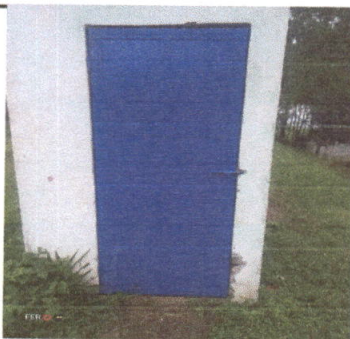
Foto 5: se observa que la puerta del baño y fue sustituido
